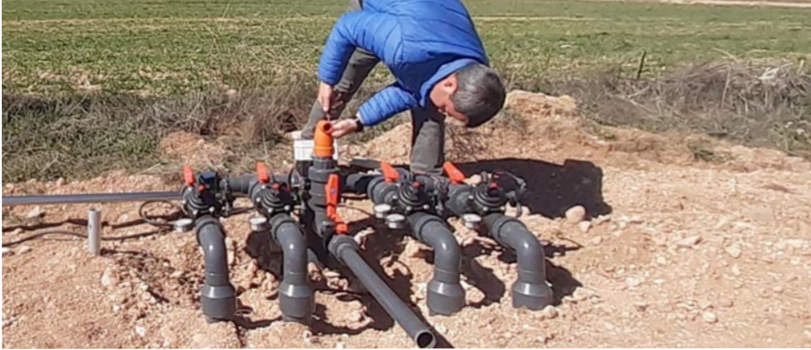
Un operario de Aiguambient Solucions, arreglando una tubería de distribución de riego
