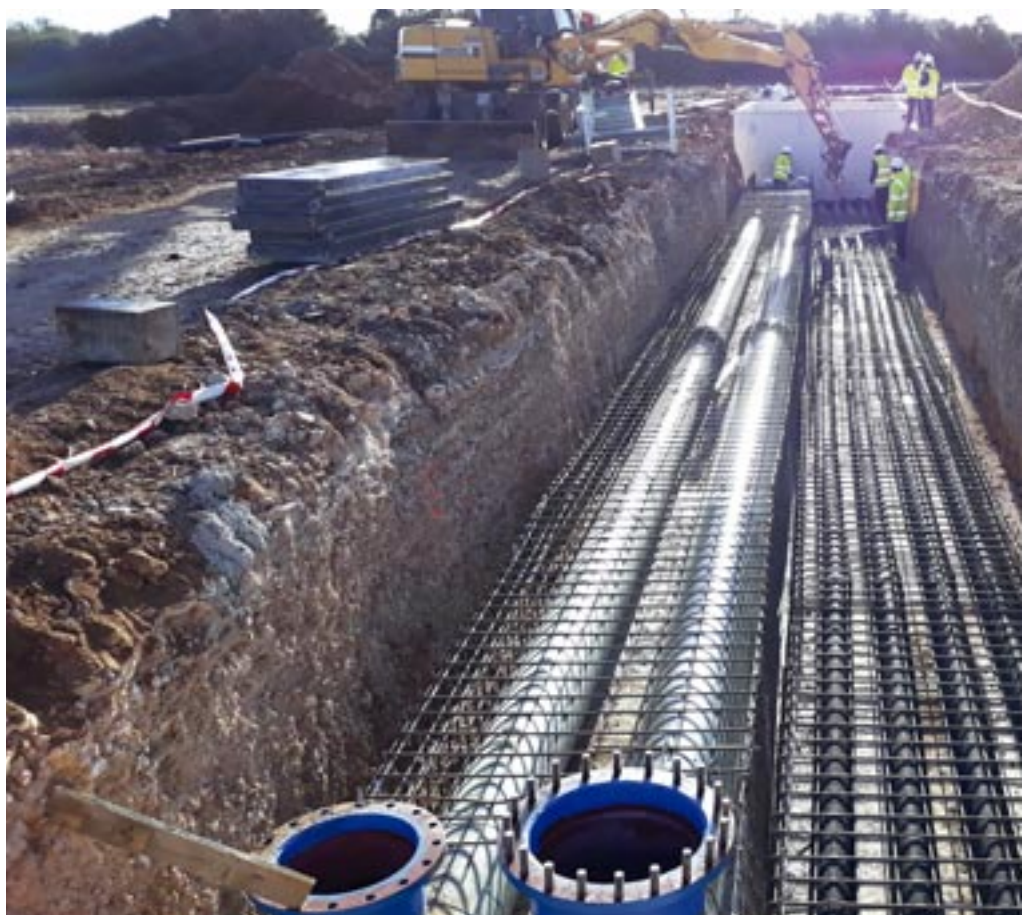
Canalizaciones construidas para transportar el agua desde las balsas hasta las fincas
