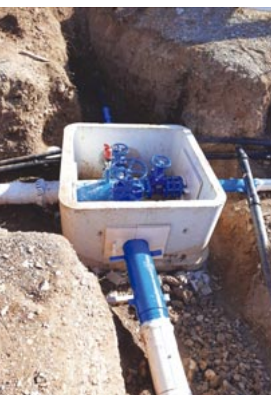
Punto de control de las tuberías
