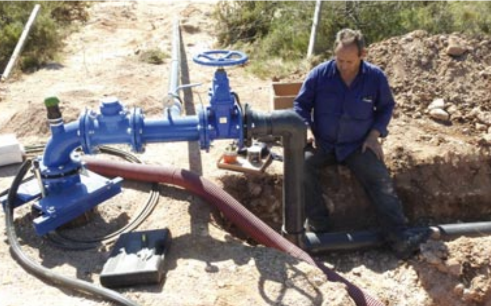
Sistema de riego instalado por Mecanizados Diago
