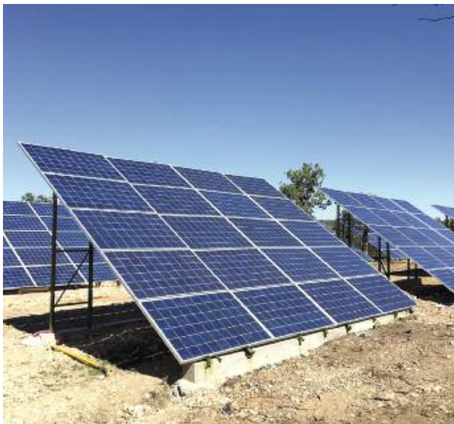
Placas solares instaladas por Hydromatic
