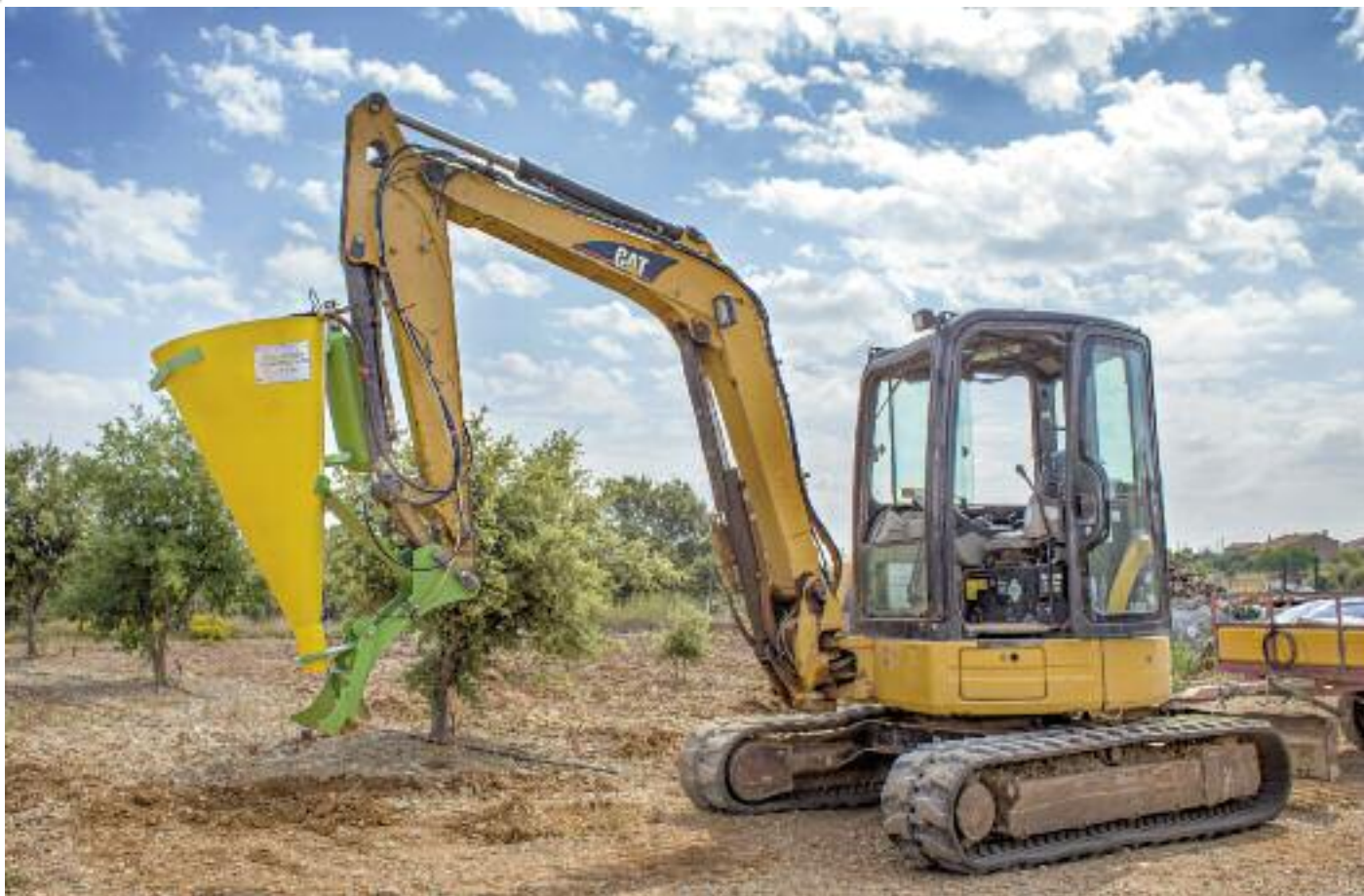
El apero para la realización de los pozos se acopla a una mini excavadora
